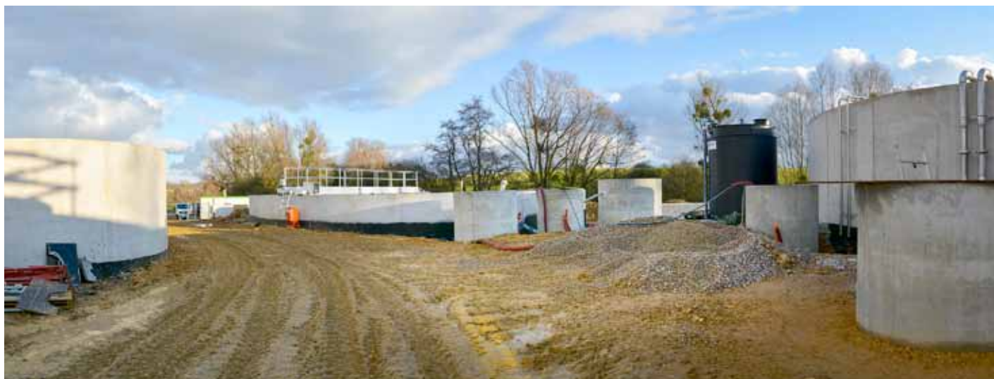
La station d'épuration située en lisière d'Hettange-Grande
